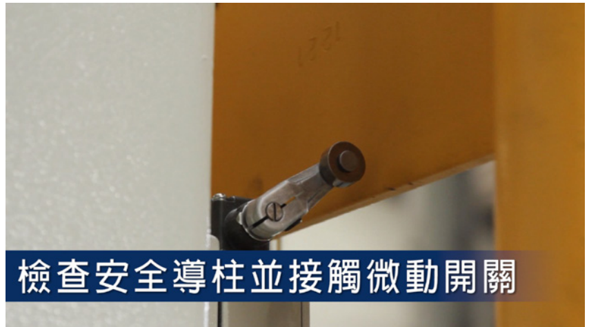
檢查安全導柱並接觸微動開關
